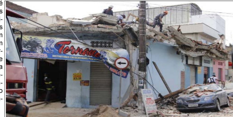
O imóvel que desabou em Cubatão não tinha autorização para reforma. Operários que trabalhavam na reforma do imóvel ficaram feridos.
