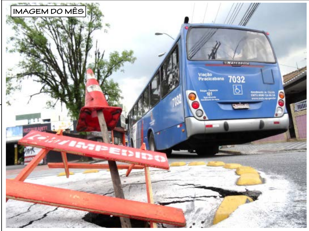
Em outubro do ano passado, apareceu um pequeno buraco bem na rotatória existente no cruzamento da Rua São Paulo com a Rua Assembléia de Deus e Rua Cidade de Pinhal. Nenhuma providência foi tomada. O pequeno buraco foi aumentando de tamanho e em 15 de fevereiro, quando foi feita essa foto, havia uma verdadeira cratera. Os comerciantes vizinhos, apenam para que as autoridades responsáveis, resolvam logo o problema, pois a qualquer momento desses vai cair um veículo na cratera, provocando um acidente grave. Fica aqui a dica a ao secretário da pasta, Eng. Pedro Hildebrando.
