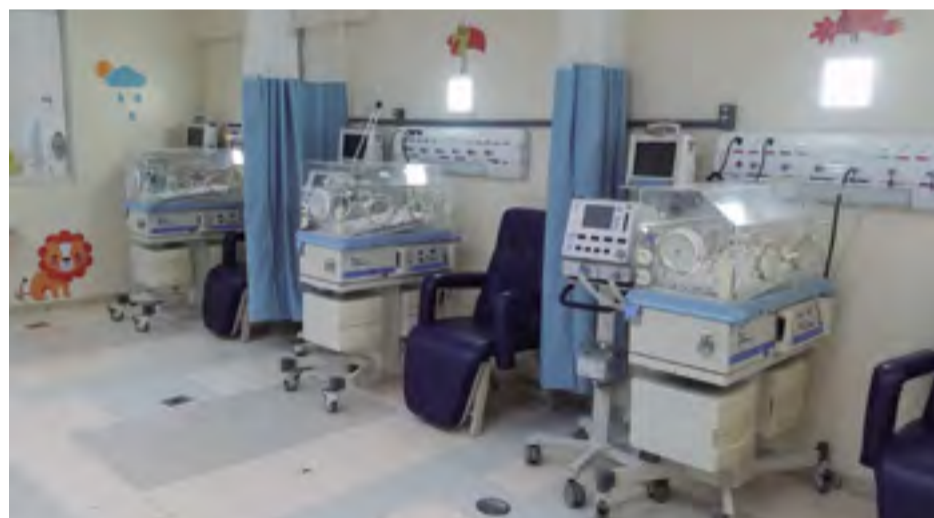
Modernas instalações da UTI Neo Natal garantem qualidade no atendimento aos bebês
