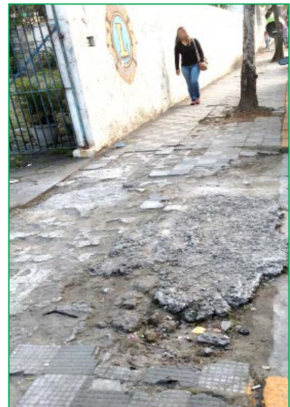
Calçada esburacada- foto feita dia 25/06/2015
