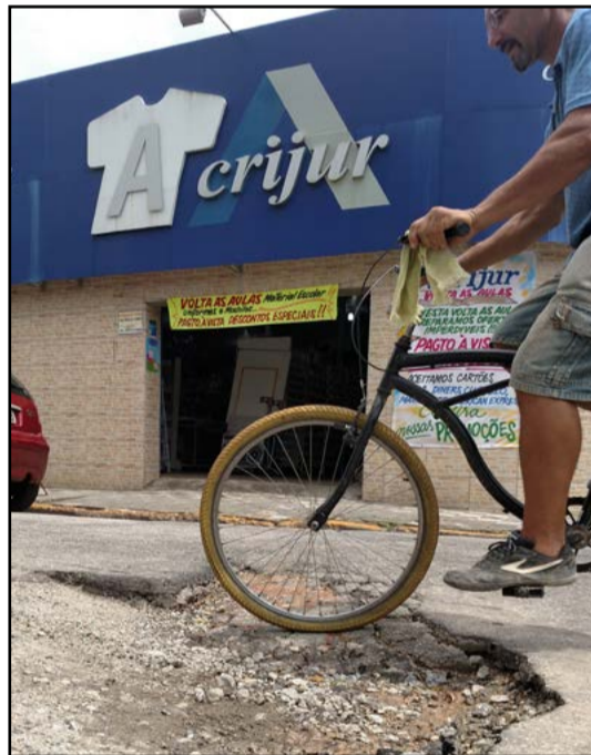
Esta cratera de quase quatro metros quadrados no meio da rua fica em frente a Acrijur
