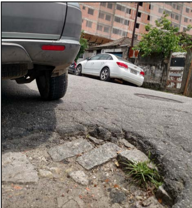
Este enorme buraco está quase em frente o restaurante "Cantinho do Sabor"
